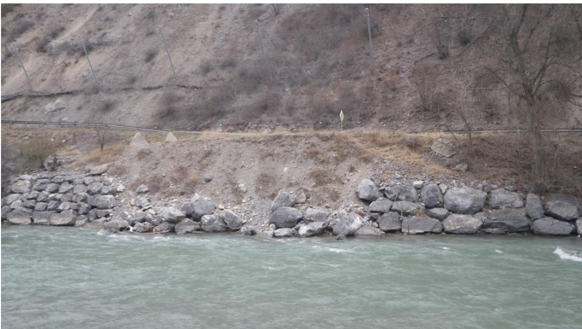
Figure 15 : Photographie de l'anse d'érosion rive gauche en limite aval du stade d'eau vive, en avril 2012 (ARTELIA)
